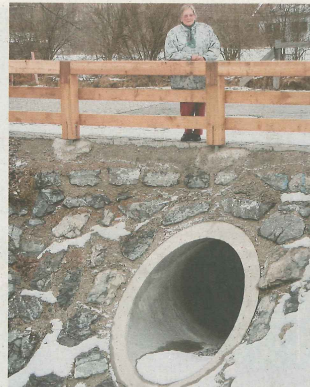
Dorothea Fürst freut sich über die fertiggestellten Maßnahmen für den Hochwasserschutz in Feldkirchen-Westerham.
